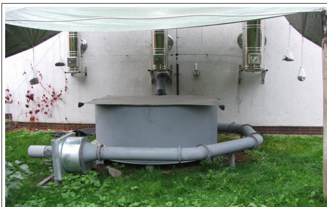
Obr. 4: Roštová sušárna VÚZT
